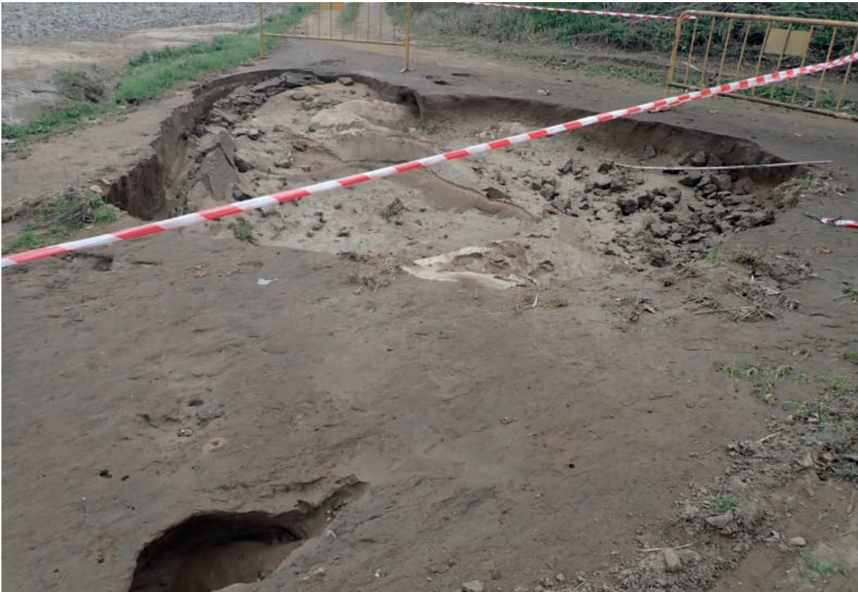
Fotografia 58. Esvoranc en mig del camí de la ruta de la Riba del Ter, a l'alçada de Canet de la Tallada.
