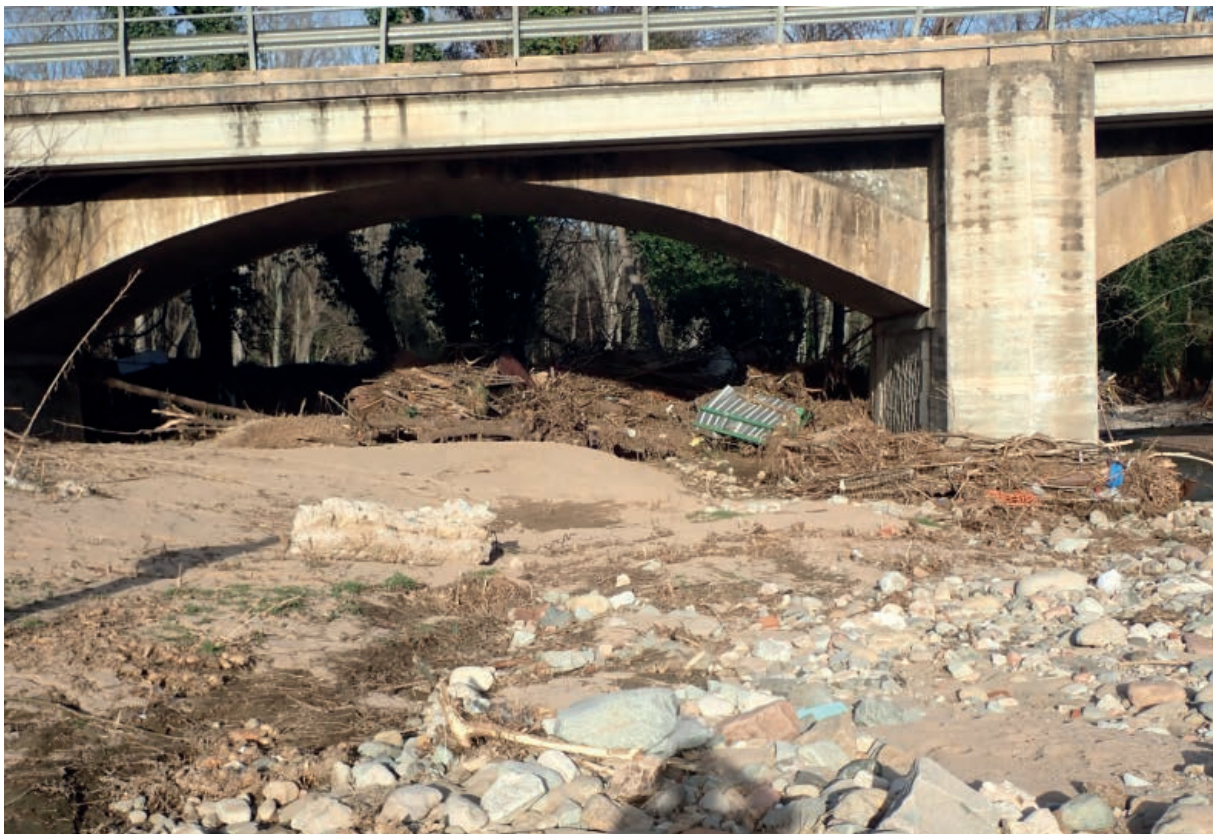
Fotografia 61. Obturació parcial del pont de la carretera C-63 al seu pas per Anglès, just en la confluència del Ter amb la Riera d'Osor.
