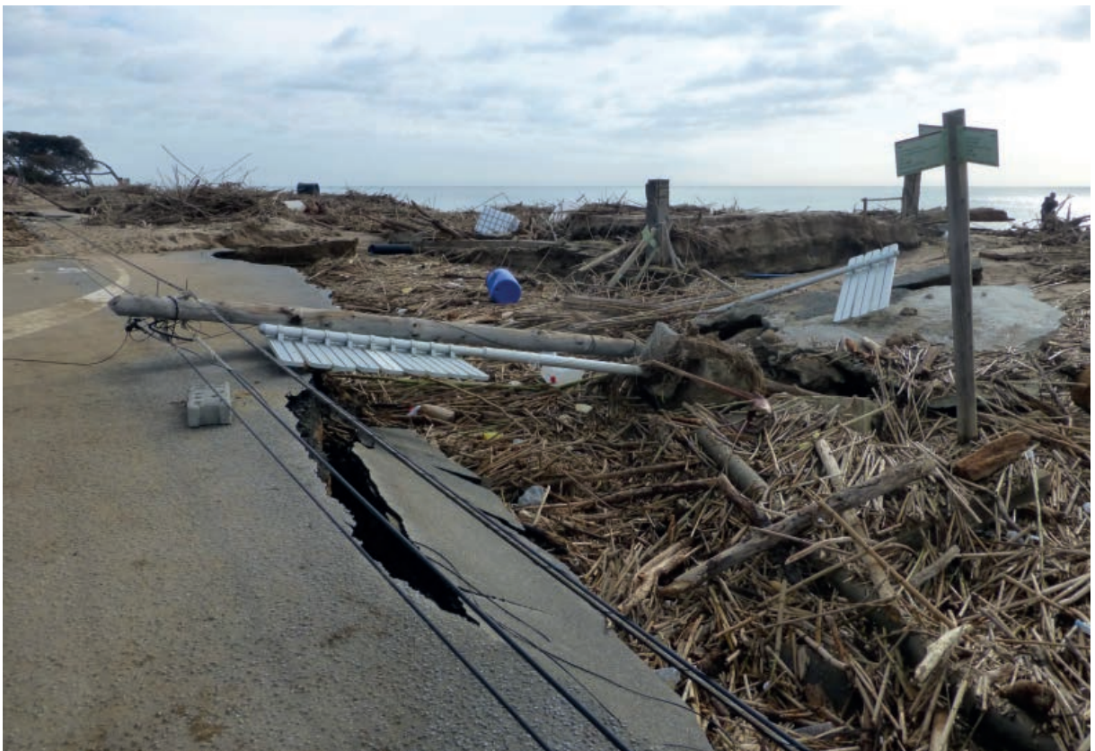
Fotografia 85. Afectacions al paviment i a la línia elèctrica davant del càmping El Pla del Mar.
