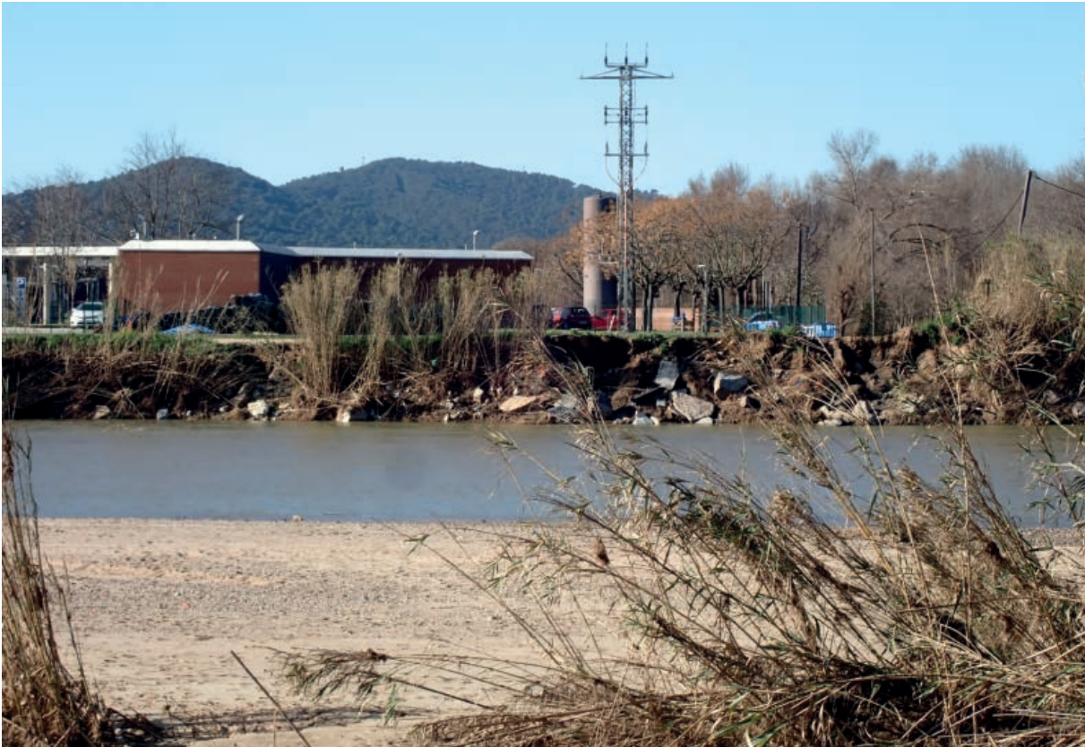
Fotografia 31. Escarpament per socavació al marge dret de la Tordera.
