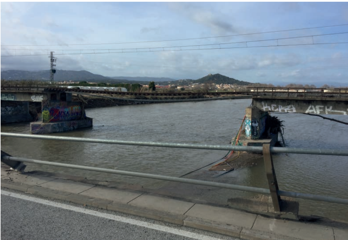
Fotografia 28. Trencament del pont ferroviari de la línia C-1.
