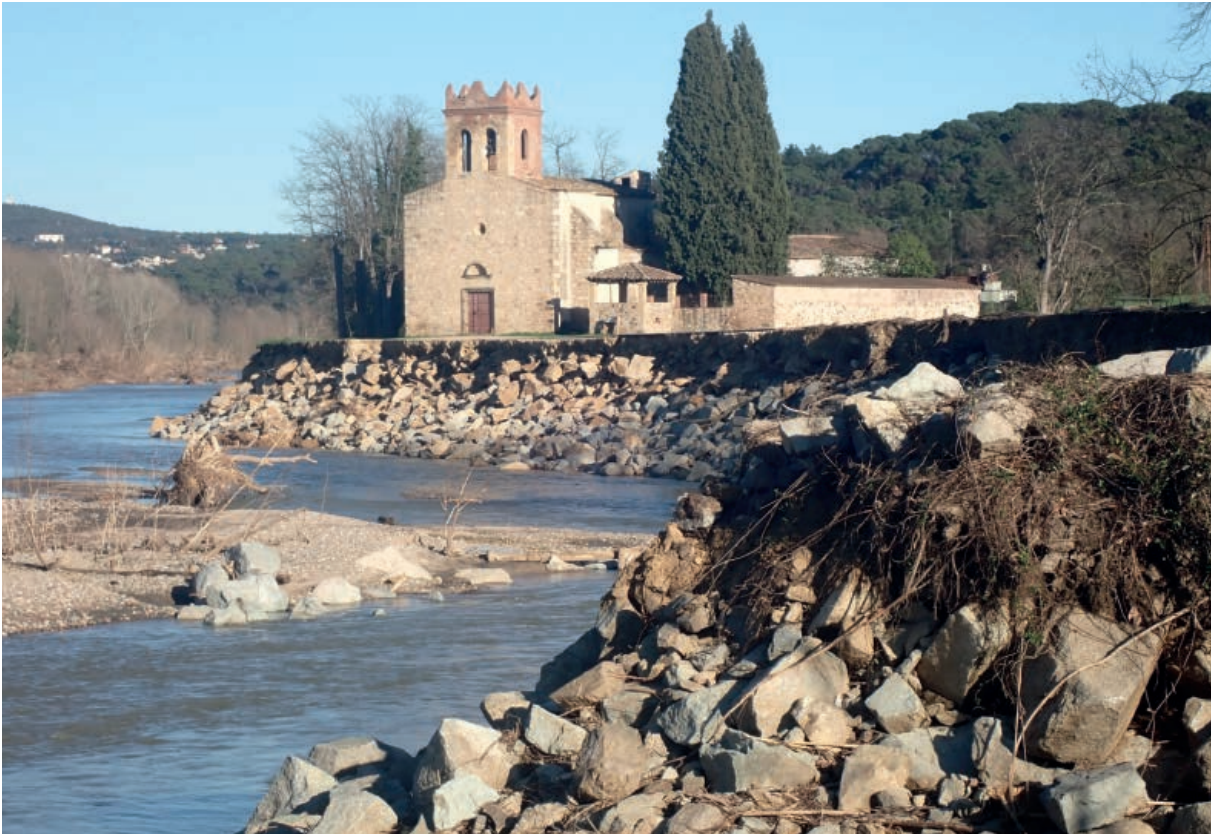
Fotografia 35. Soscavació de l'escullera a Sant Cebrià de Fogars.
