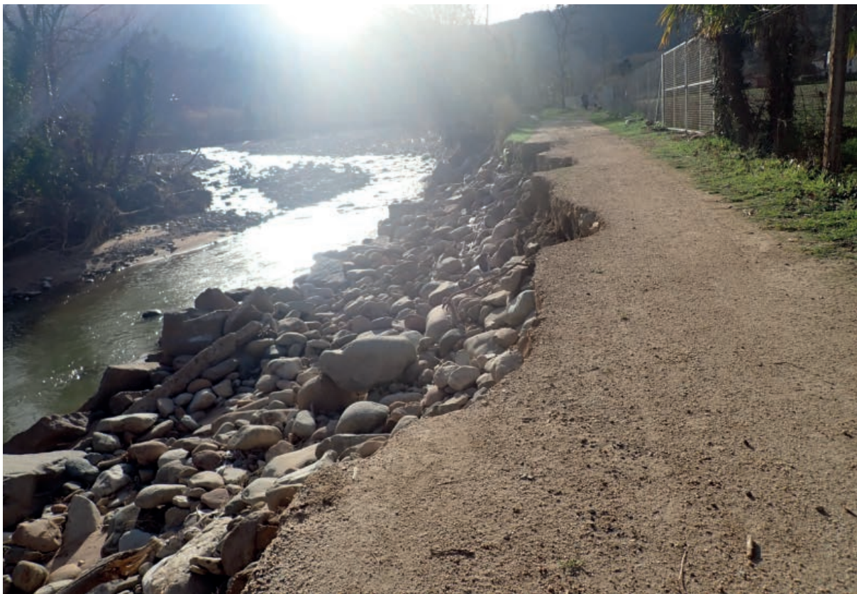
Fotografia 62. Afectació parcial del camí que va a Can Serinyà, part baixa de la Riera d'Osor.
