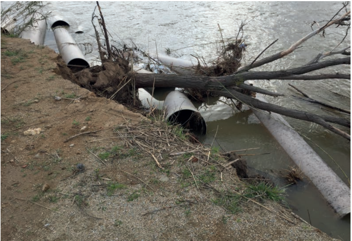
Fotografia 30. Trencament dels tubs emissaris i de captació de la planta dessalinitzadora de la Tordera.
