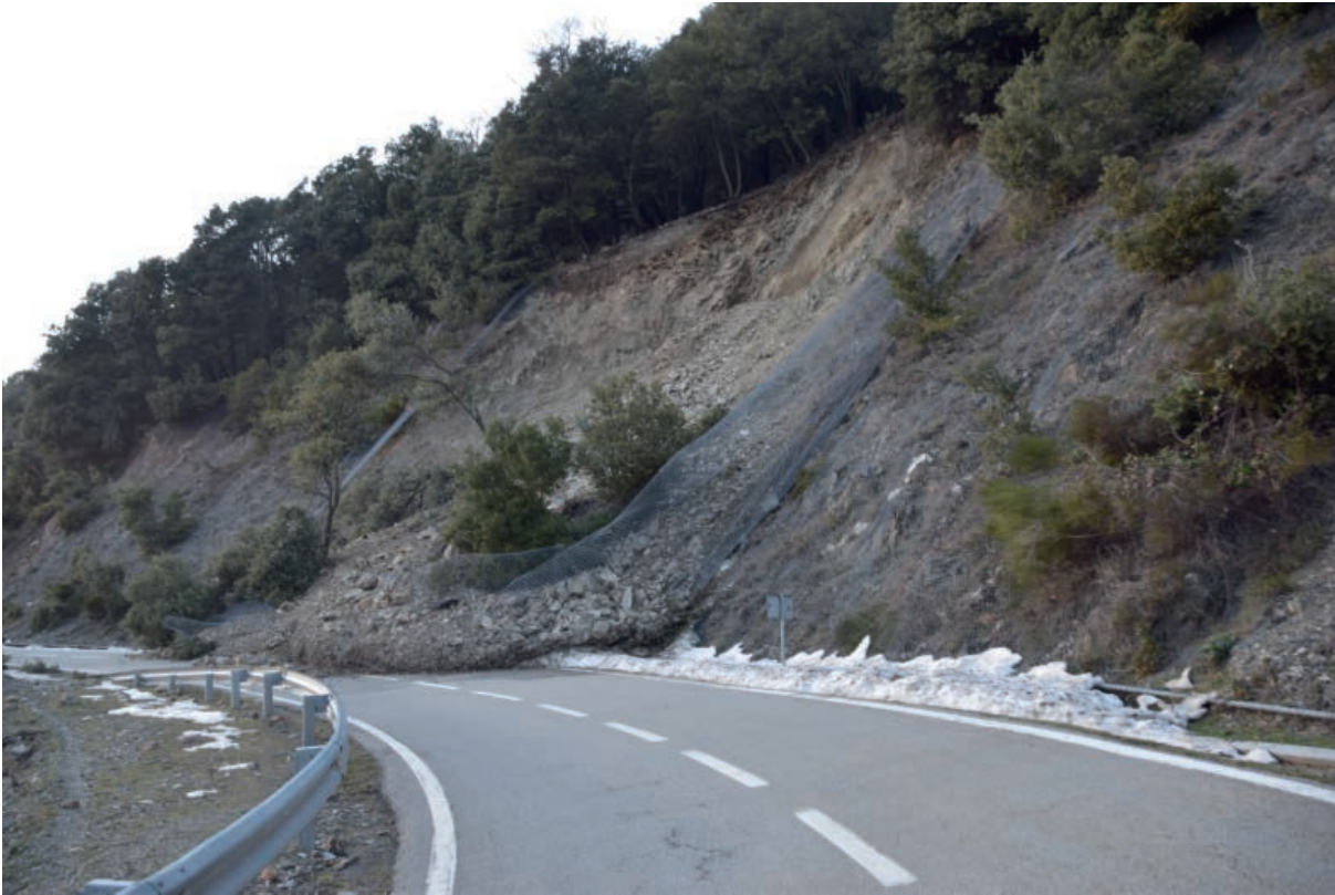
Fotografia 1. Esllavissada a la BV-5301 pk 25+060 (el Brull, Vallès Oriental) en un talús on s'ha destruït la xarxa instal·lada.
