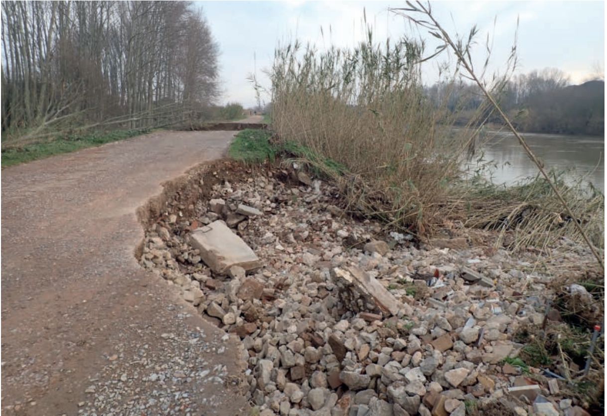
Fotografia 56. Afectació del camí que va paral·lel a la vora esquerra del Ter, a l'alçada de Torroella de Montgrí.
