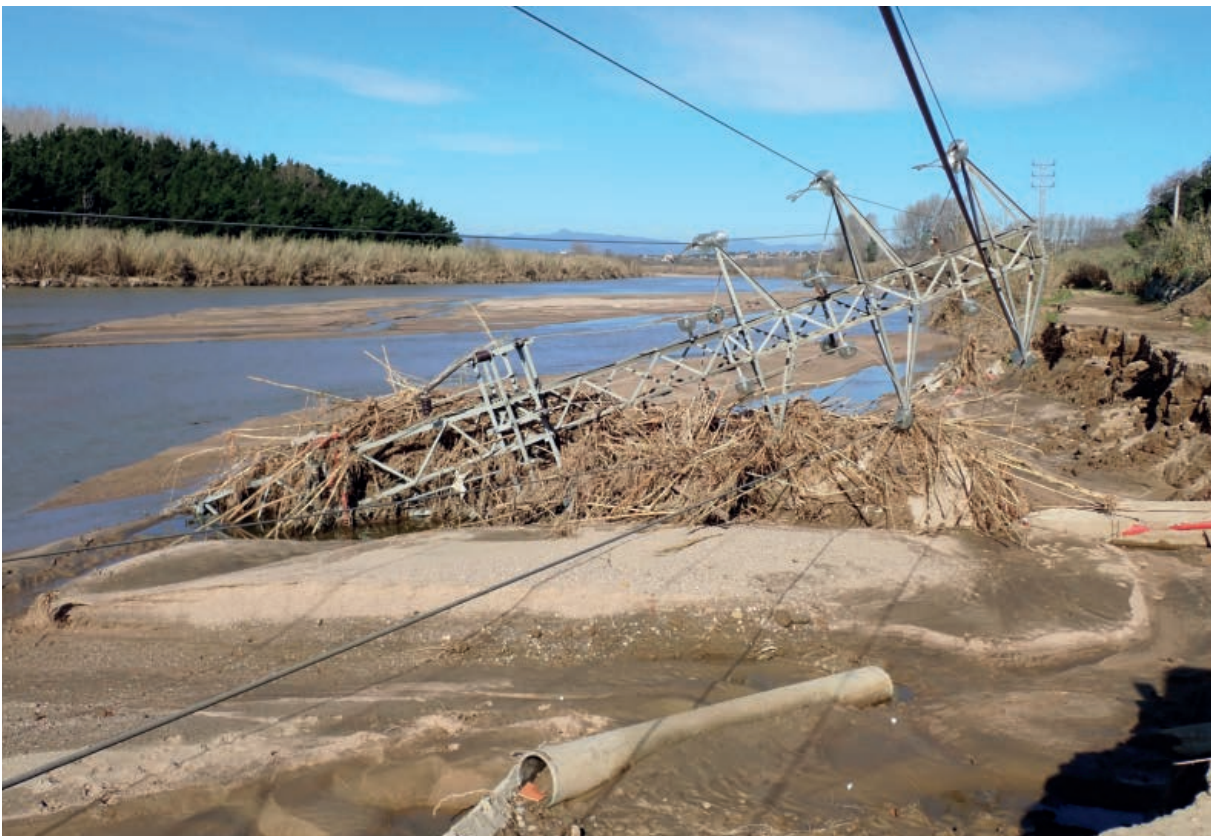
Fotografia 32. Afectació d'una torre d'alta tensió a la Plantera, marge esquerre de la Tordera.
