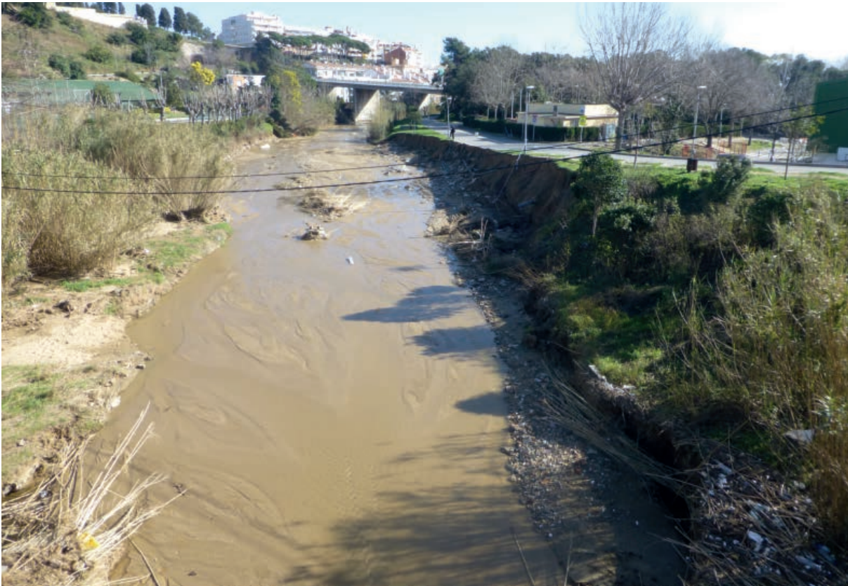
Fotografia 74. Soscavació al marge dret de la Riera de Sant Pol i afectacions a la vorera del carrer.
