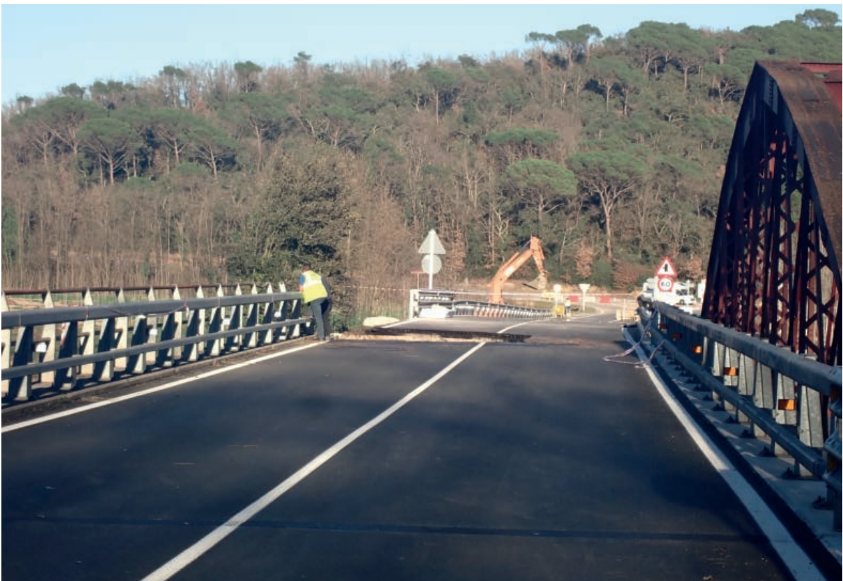
Fotografia 36. Esfondrament al pont de la C-35 entre Hostalric i Maçanet de la Selva.
