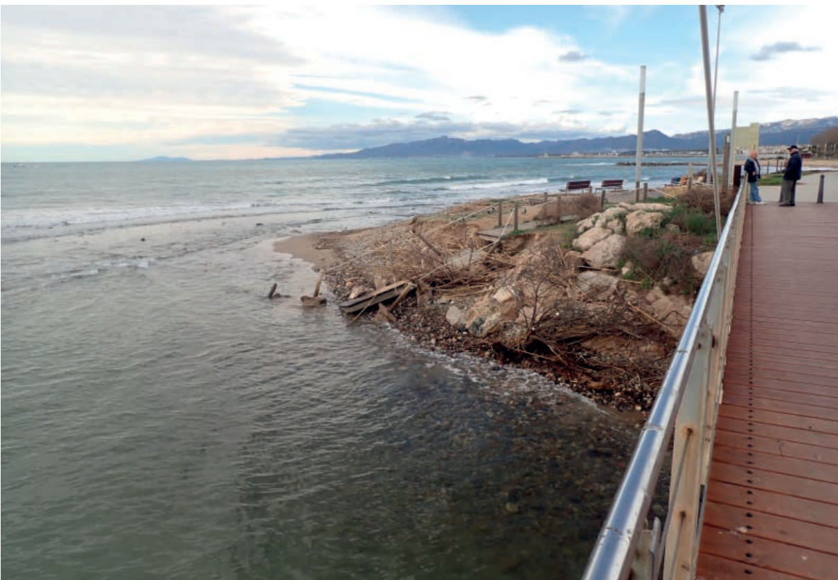
Fotografia 67. Erosió a la desembocadura de la Riera de Riudoms, Cambrils.
