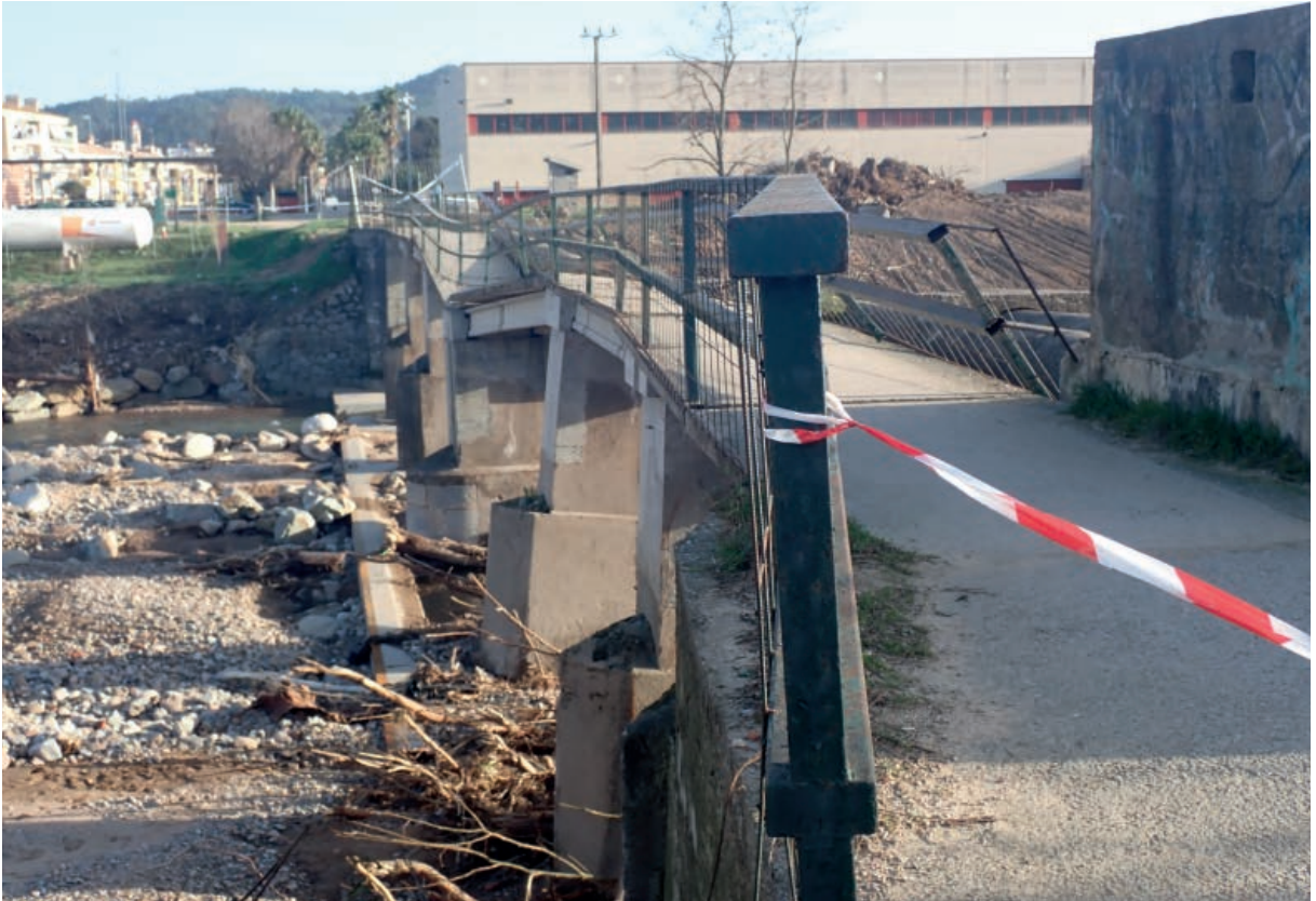
Fotografia 60. Antic pont que va de la Celler de Ter a Anglès amb una canalització. S'observa com ha quedat greument malmès.
