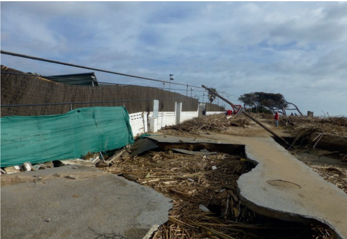
Fotografia 87. Esfondrament del paviment i d'un mur del càmping Blaumar, i afectacions a la línia elèctrica.
