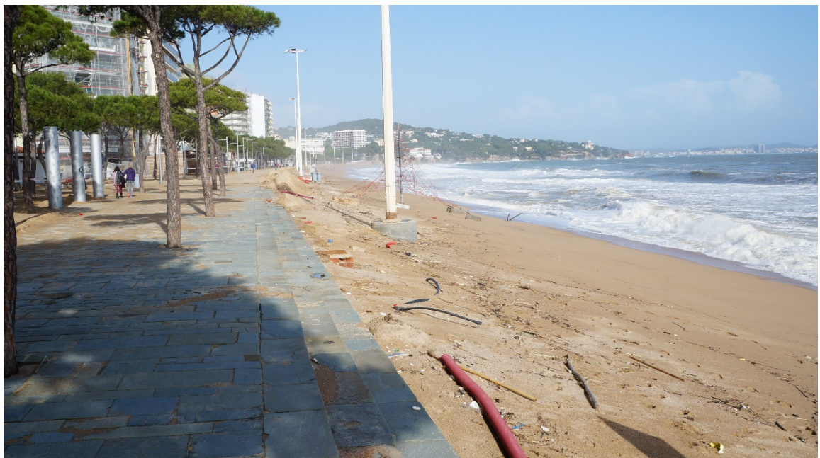
Figura 17. Impacte de la tempesta Glòria a Platja d'Aro. S'aprecia erosió a la platja emergida, afectacions al mobiliari urbà i al passeig marítim, on també s'hi va acumular sorra.
